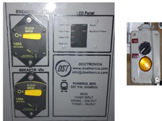
Ilustración 6. Estado de breakers de entrada (Izquierda). Estado del control remoto (Derecha)
