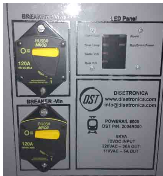
Imagen 7: Vista Frontal del Inversor
