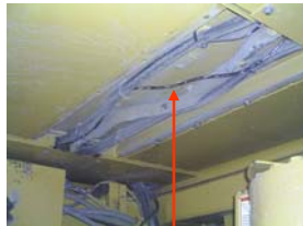
Arnés enrutado en bandeja inferior de la cabina
